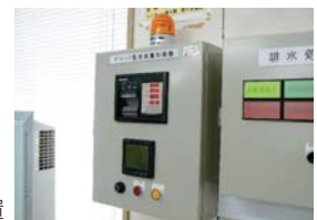
デマンド監視装置
