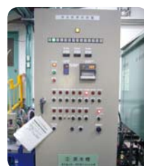
排水管理操作盤
