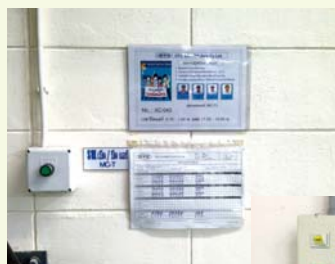
エアコン管理者と管理内容およびチェックシート
