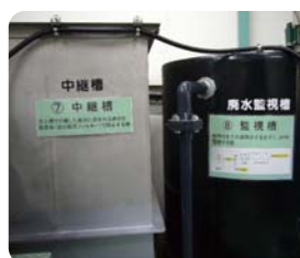
排水管理中継槽・監視槽
